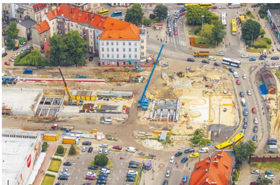
Najbardziej intensywne prace prowadzone są w obrębie przyszłego tunelu pod ul. Zwycięstwa i Dworcową. Cały obiekt jest już przekopany!
